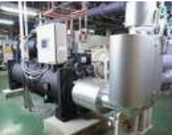
核物理研究センターに設置されたインバーターボ冷凍機
