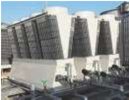
レーザーエネルギー学研究センターに設置された空冷モジュールチラー
