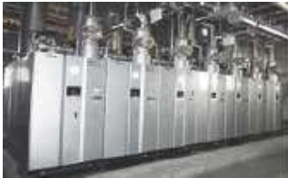
医学部附属病院に設置された小型貫流ボイラー
