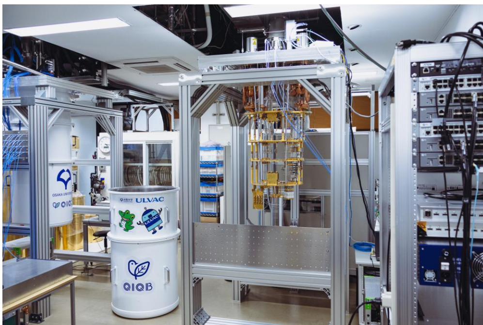
図：純国産量子コンピュータ設置の様子。中央の黄金のシャンデリアのようなものが希釈冷凍機内部、右側に写る紺色のボックスが制御装置、左側には 2023 年稼働のマシン。
