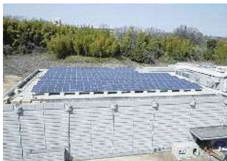
太陽光発電設備 (吹田・核物理研究センター)
